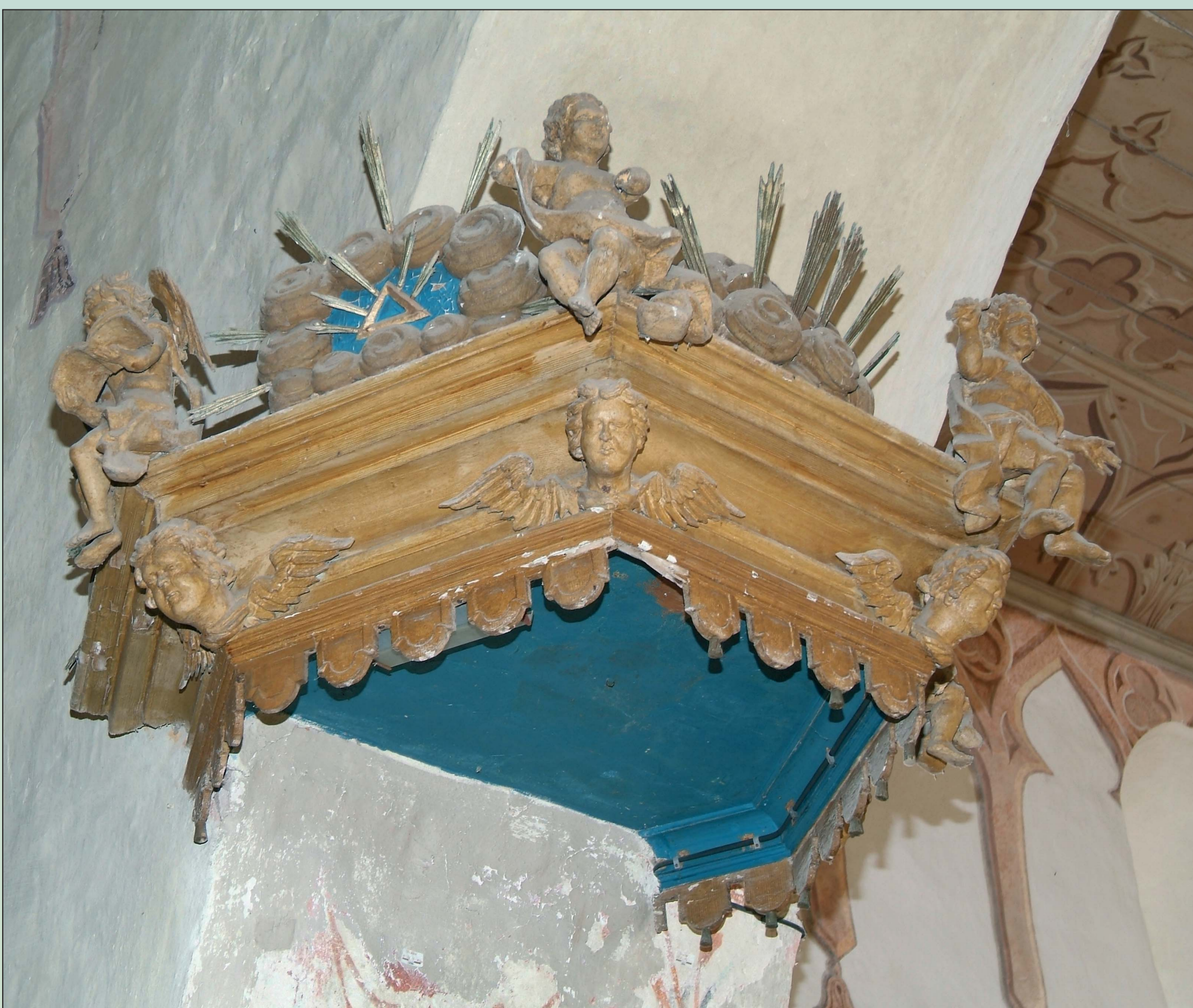
Schwere Schäden am Schalldeckel der Kanzel
