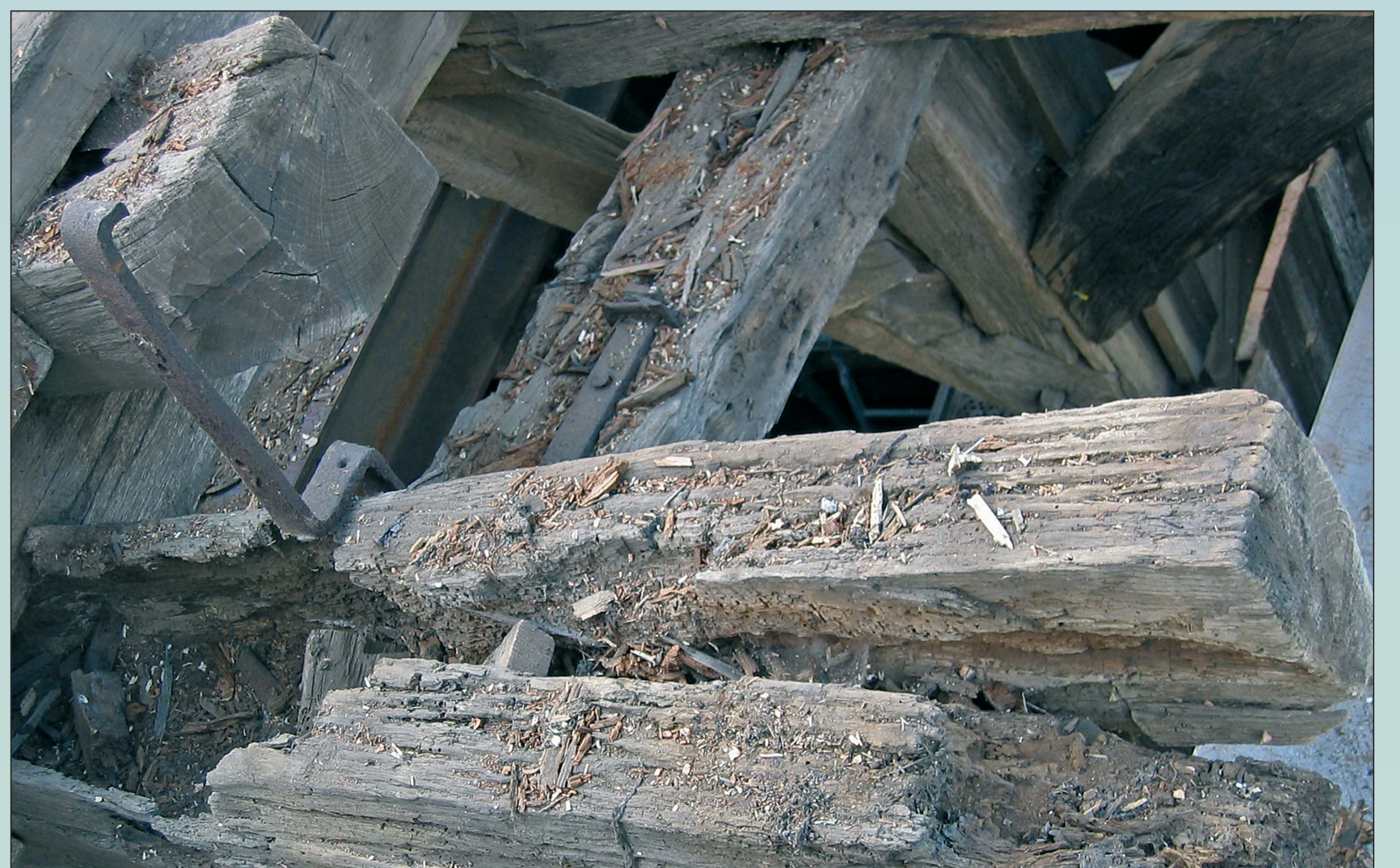
Morsche Balken im Holzturm
