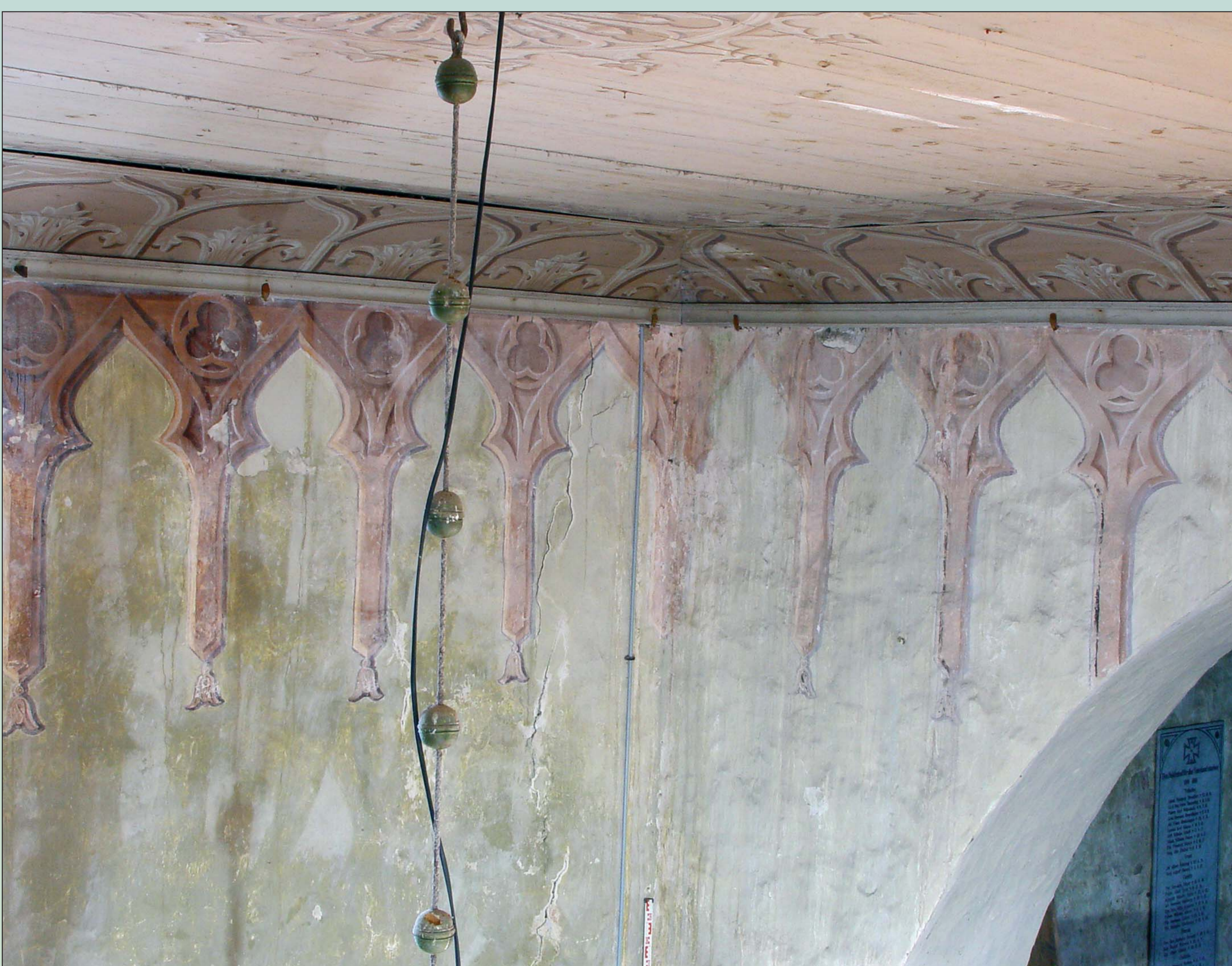
Schäden durch Feuchtigkeit und Risse im Innenraum
